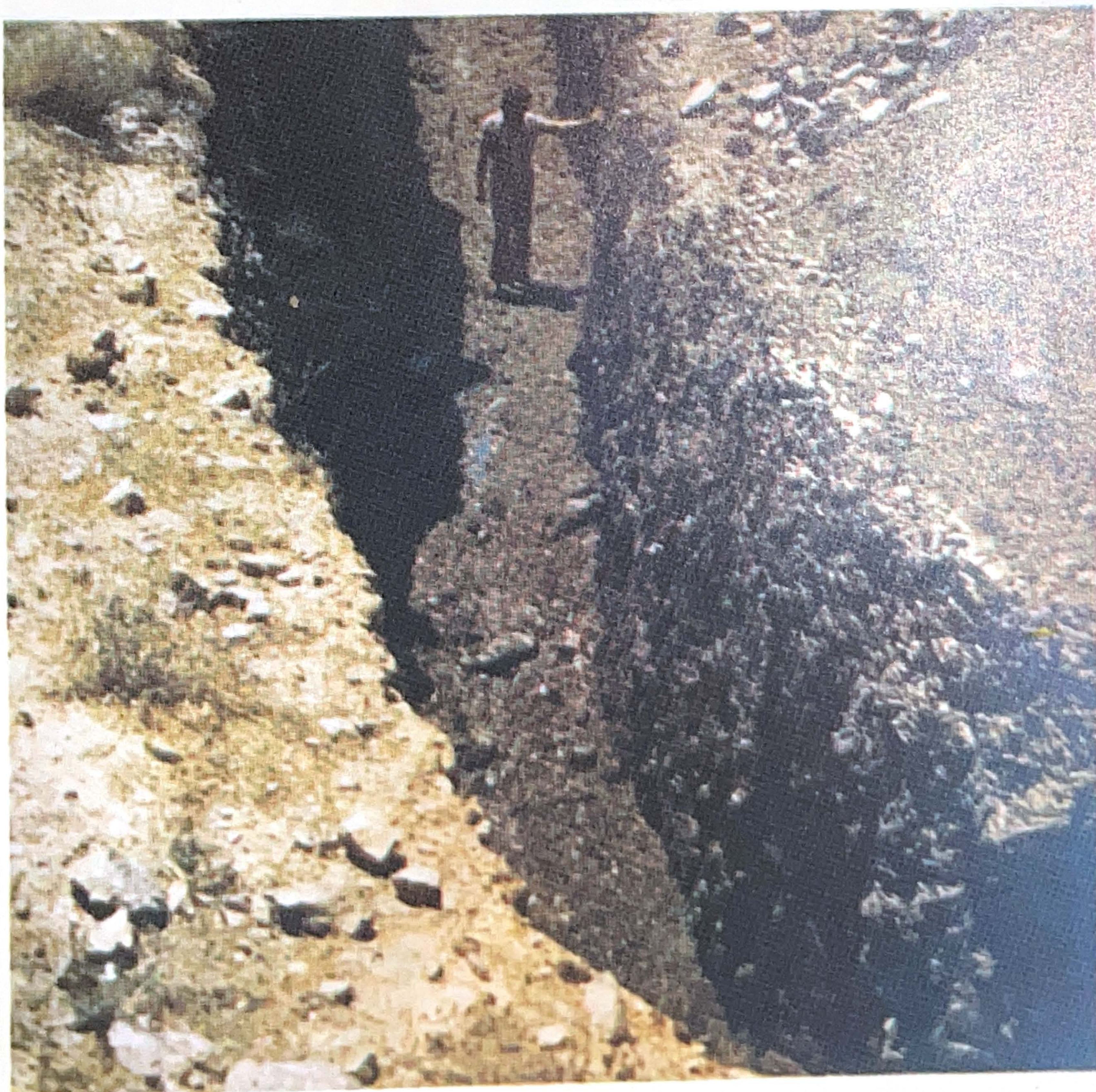
B. کف زهکش و دیواره مجاور منطقه لغزنده قیرپاشی شده است .
